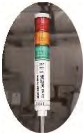
機械の運転 状況を表示するパトライトと自動加湿機
